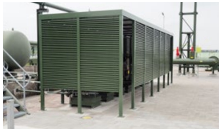
Wände verkleidet mit Storax Lamellen Typ ST-050 HF, Olivegrün pulverbeschichtet
